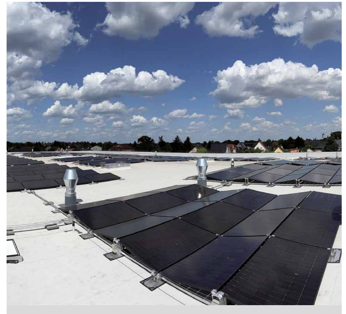
Aufdach-PV-Anlage auf Bestandshalle, errichtet von MBG energy, ein Unternehmen von SPIE Germany Switzerland Austria, Copyright MBG energy
