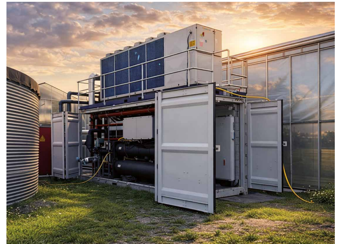
Bild 2: Modulare Heizungsanlage von Sprinkler Energy und SPIE mit zwei Wärmepumpen im Container, Copyright Sprinkler Energy
